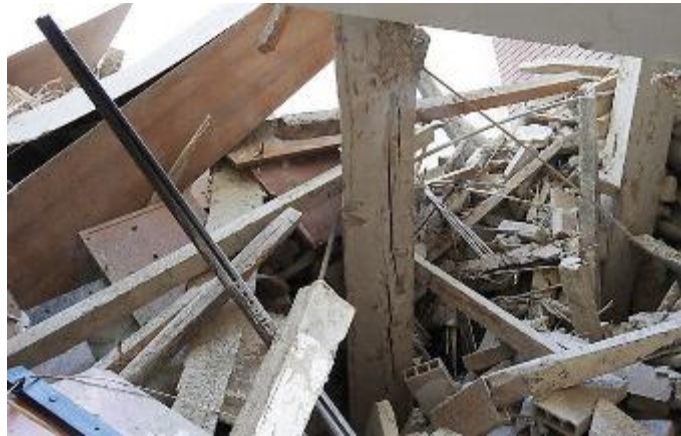
ALL'INTERNO Travi spezzate e muri crollati nell'abitazione
